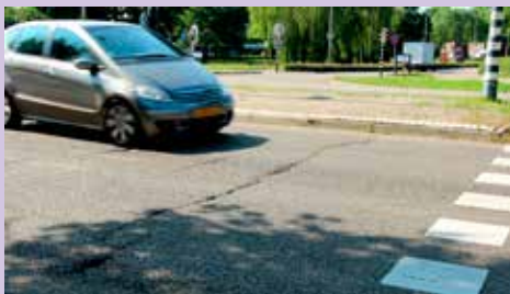
Scheuren in de Van Schuylenburgweg
