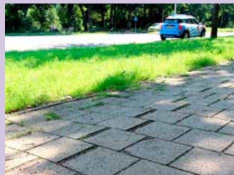
Slecht fietspad in Tolhuis ter hoogte van 10 e straat Zwanenveld
