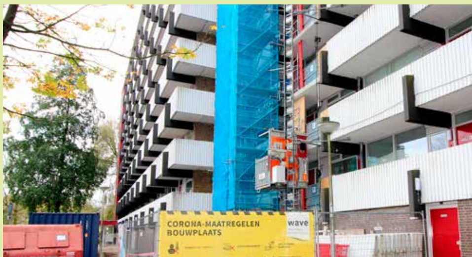
De bouwlift met, in blauwe netten, de trappen aan de buitenkant van het gebouw
