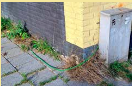
'Externe' kabelaansluiting in Meijhorst
