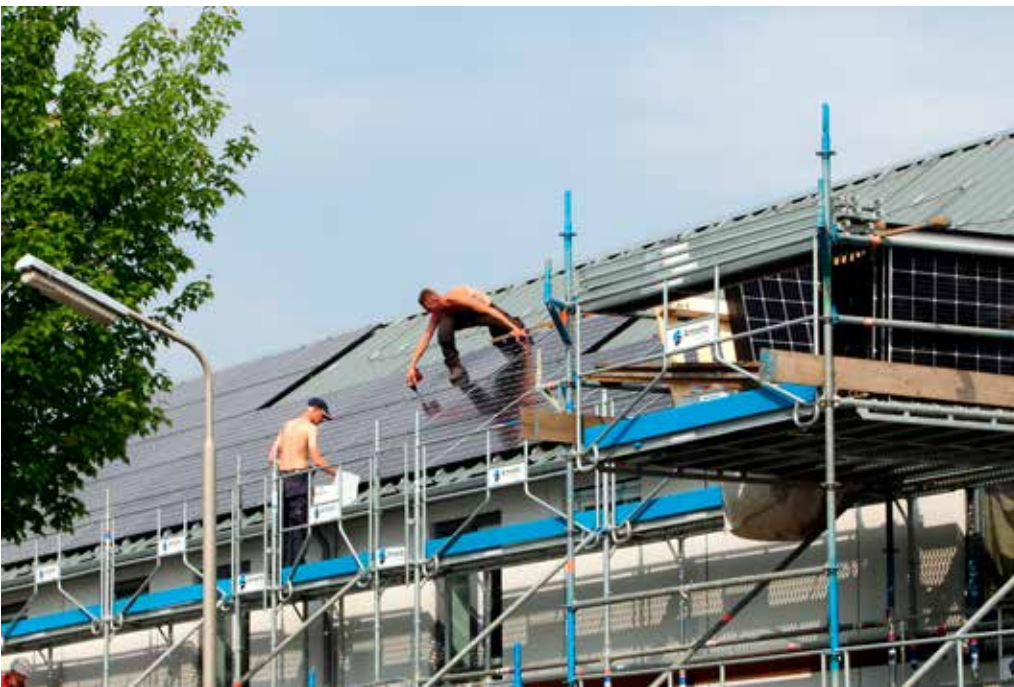
Zonnepanelen bedekken het hele dak. Meijhorst, 9 mei 2019
