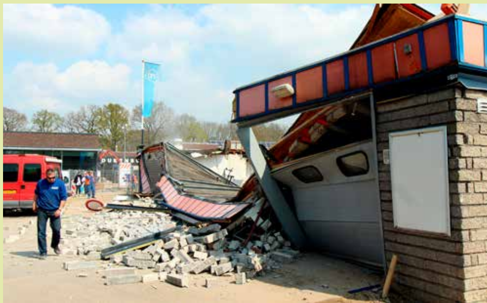
Stenen vlogen over de parkeerplaats, de omgevallen muur
